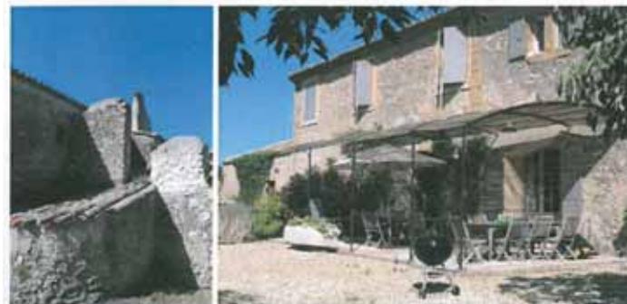
Vue de la façade Sud du corps principal et vue de détails de l'arrière du bâtiment principal. Ces photos montrent les matériaux existants.
